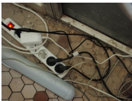
Figure 1 : branchements électriques dangereux
